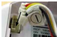
Kabelstrang des Akkus
